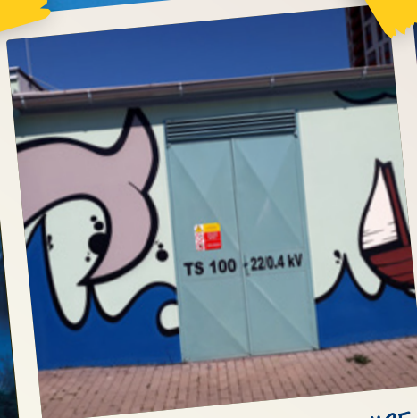
# STÁ CHYTRÁ TRAFOSTANICE
