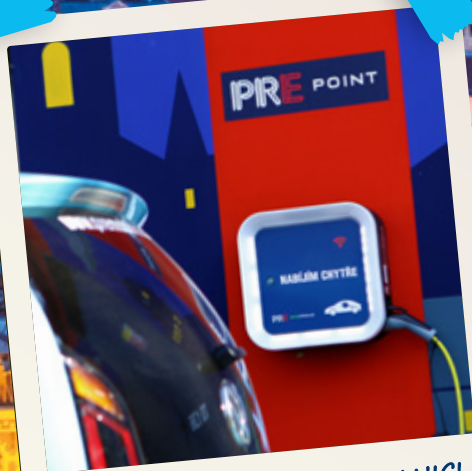
# WALLBOX NA TRAFOSTANICI
